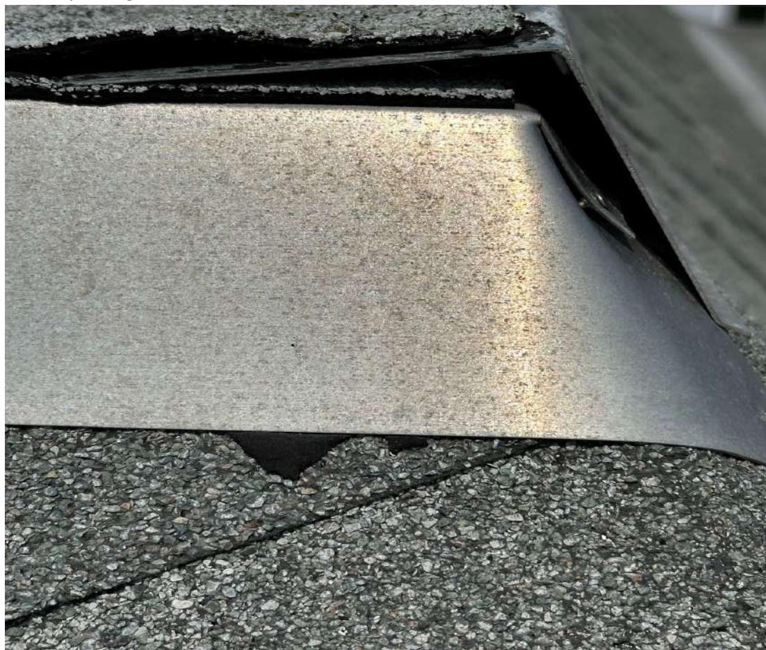
P-71 Gap in Edge Metal
