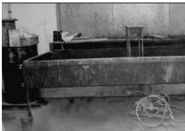
Cuve de trop-plein
